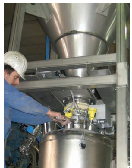
Justierarbeiten bei Wiederinbetriebnahme
